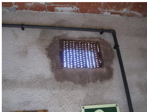
Il·lustració 31. Dipòsit Vell: sala d'emmagatzematge i dosificació d'hipoclorit sòdic
