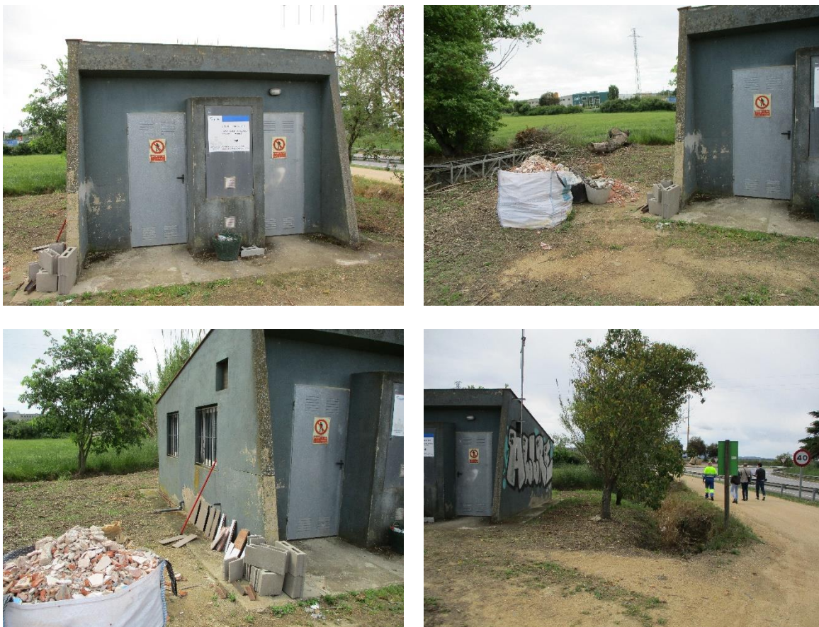
Il·lustració 15. Sobreelevació Ter: estat exterior instal·lació
